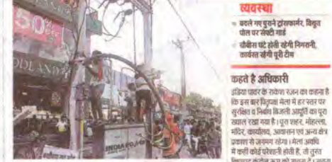
राजधानी-नया मंडी पर बिजली घर की मरम्मत करते मिली : अद्य
